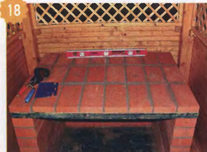
18 Ниша для дров перекрыта кирпичом по стальным уголкам.
