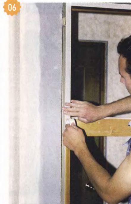
06 Если не защитить малярной лентой поверхности дверной коробки, попавшую на них монтажную пену трудно будет удалить, не повредив отделку.
